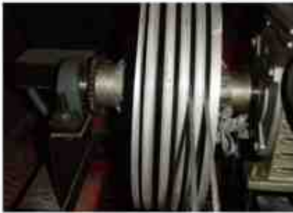
디스크 드럼 가공 상태 불량
