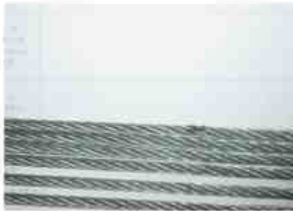
용접 불동에 의한 파손
