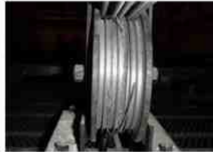
황차 풀 그룹부 파손
