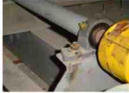
베어링 지지대 고정 볼트부 파손
