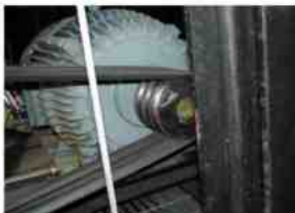
전동기 풀리 파손
