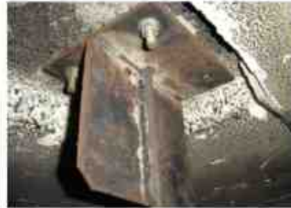
용접불량 및 앵커볼트 탈락
