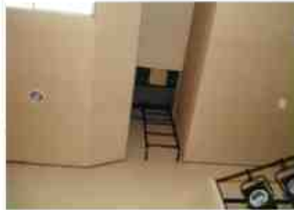
상부 진입 계단 및 사다리 미확보
