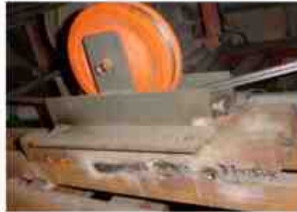
활차 고정 지지부 용접 상태 불량
